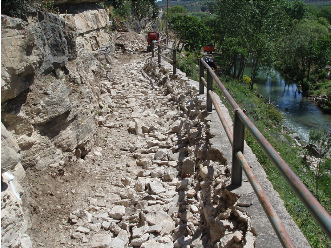
Lámina 1. Aspecto del pavimento picado.
